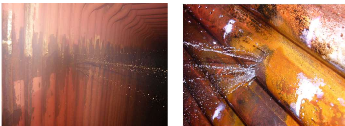
Obr. 1: Havárie membránové stěny z oceli T24 po 400 hodinách provozu.
